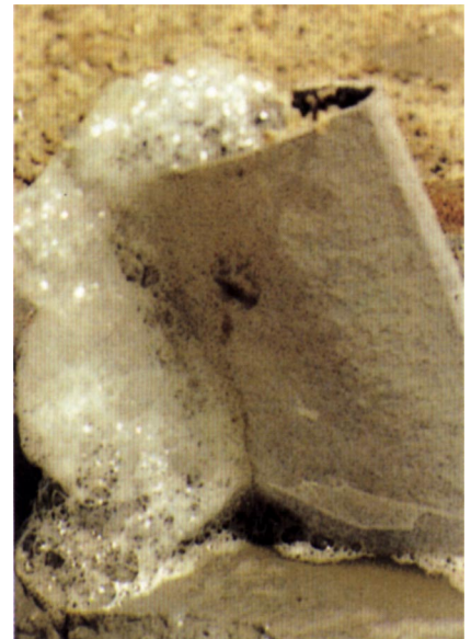
Výtok pórové vody z geodrénu
